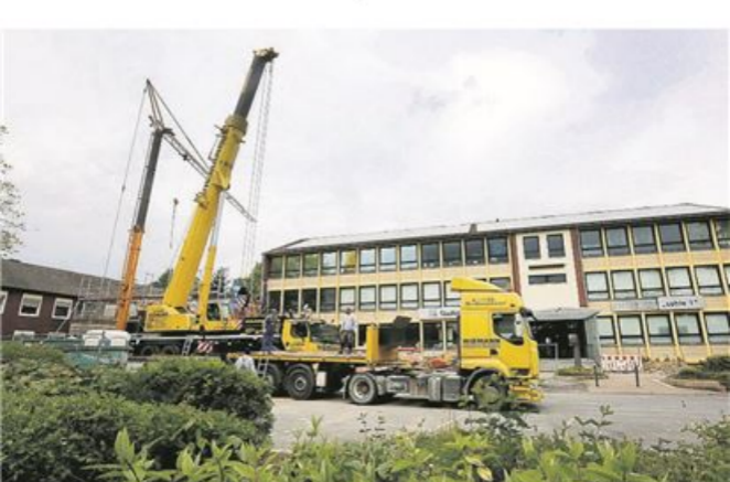
Die Bauarbeiten für den Neubau am Stadtmuseum schreiten voran. Bald bekommt der Rohbau ein Dach.
