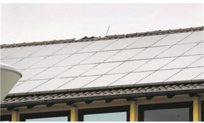
Der Baukran hat das Dach des Hauptgebäudes touchiert, der Schaden ist inzwischen behoben.
